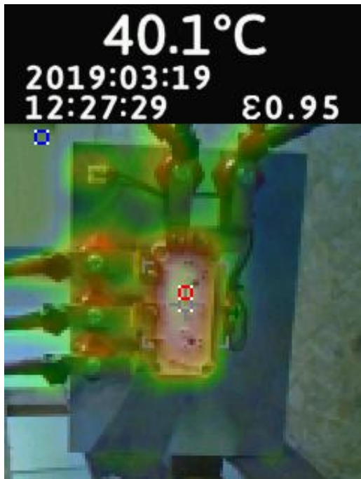
Obrázek 21: Termovizní snímek usměrňovače
