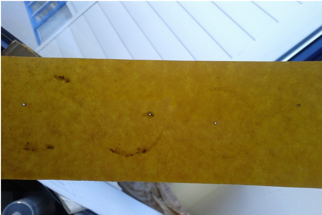
Obr. 11: Lepenka po měření s viditelnou degradací a průrazy
