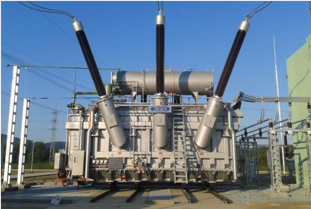
Obr. 3: Třífázový autotransformátor 350 MVA, převzato [40]
