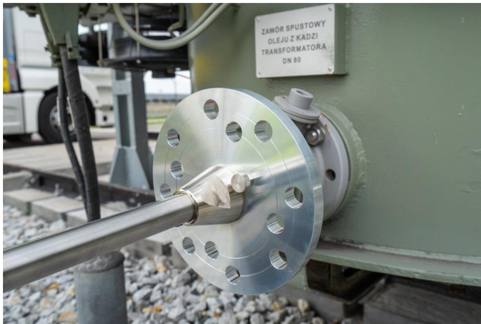
Obrázek 4: Okno transformátorové nádoby s nainstalovaným UHF senzorem [28]
