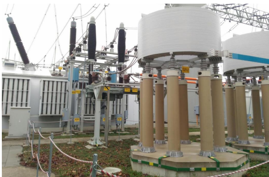
Obr. 27 - Reaktor na terciární straně transformátoru [16]
