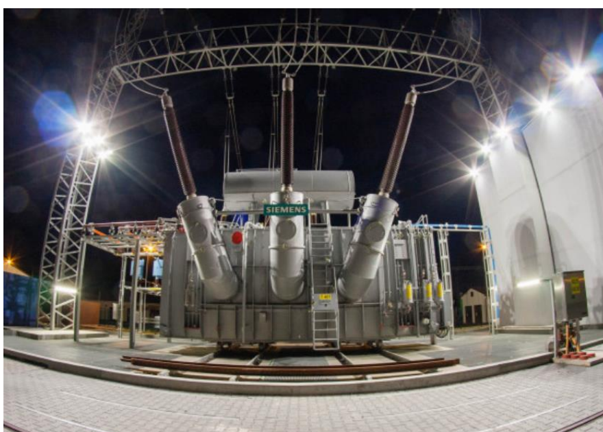
Obr. 26 - Transformátor Siemens 350 MVA
