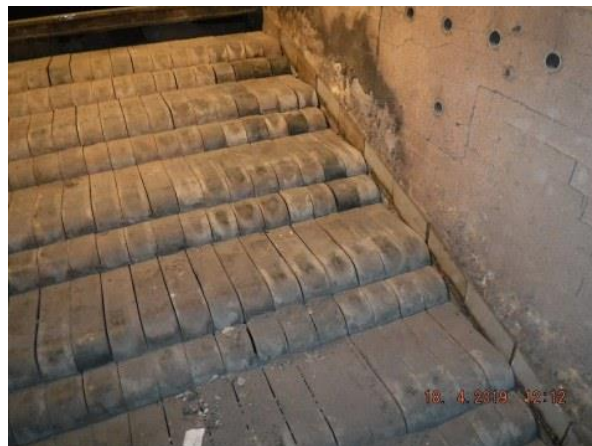
Obrázek Příloha č.1-3 Rošt kotle [autor]
