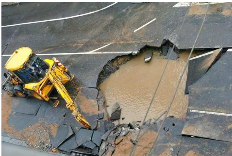
Obr. 3-1 : Škody vzniklé na komunikaci [8]
