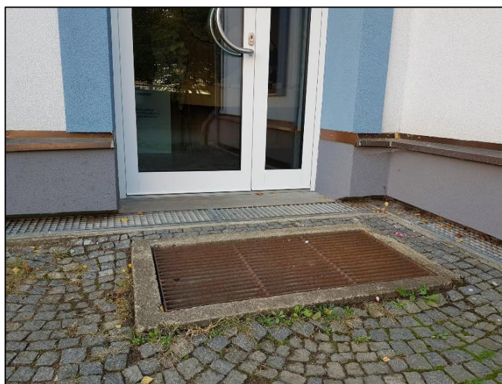
Obrázek 42 - Vystupující čistící rošt před vstupem do Budovy OÚ 1 (rošt zvýšený o 30 mm, překážka pro vozíčkáře, mezery roštu jsou vyhovující), zdroj: autorka DP
