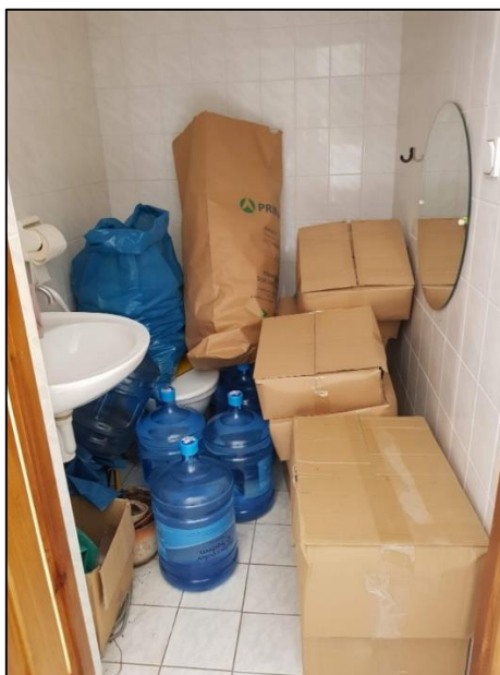
Obrázek 59 - Bezbariérové WC v Budově OÚ 2 (v současné době mimo provoz, nevyhovující rozměry místnosti), zdroj: autorka DP
