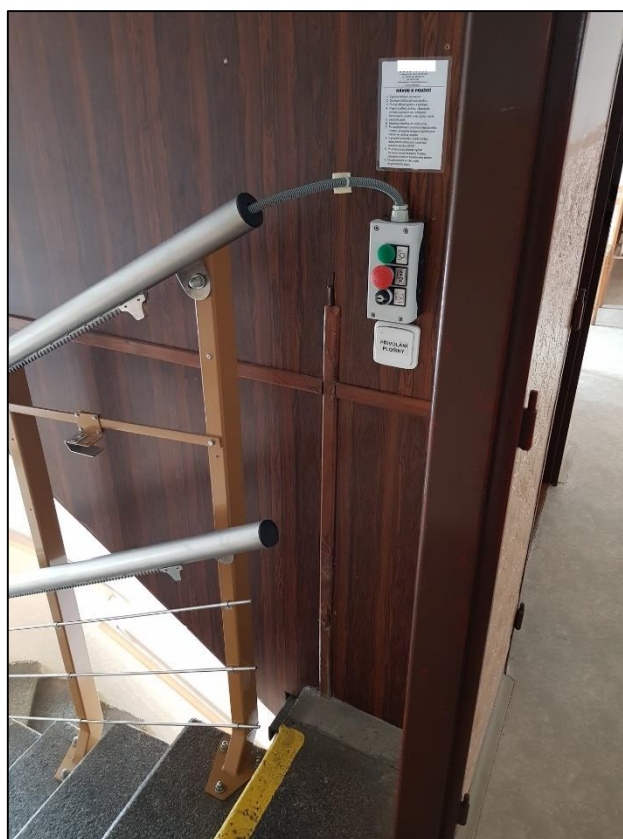
Obrázek 90 - Ovládací panel schodišťové plošiny (nutná obsluha), zdroj: autorka DP
