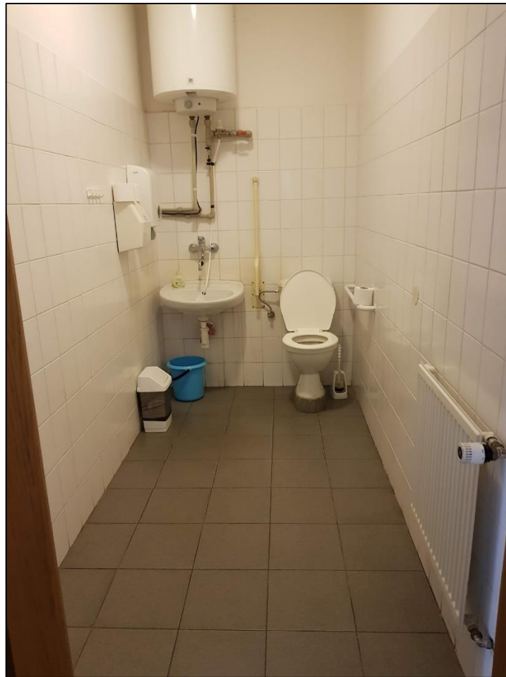
Obrázek 29 - Příklad chybně provedené bezbariérové WC kabiny (nevhodné umístění zařizovacích předmětů), zdroj: autorka DP
