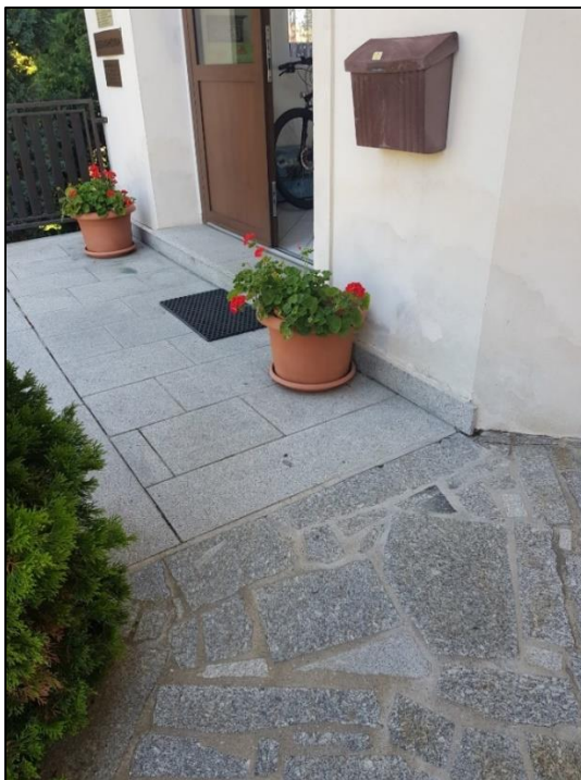
Obrázek 55 - Pohled z chodníku na vstupní dveře a stupeň (překážky: květináč na podestě a 120 mm vysoký stupeň u dveří), zdroj: autorka DP
