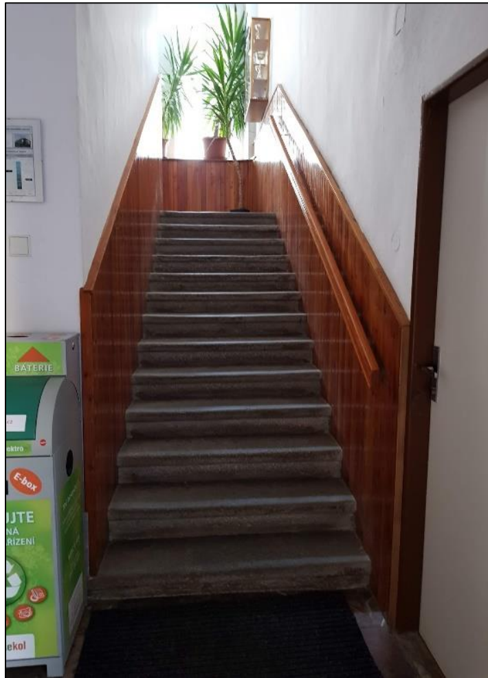
Obrázek 45 - Nástupní schodišťové rameno uvnitř Budovy OÚ 1 (šířka je zúžena dřevěným obkladem, madlo je chybně pouze na jedné straně a bez požadovaných přesahů, prostor mezipodesty je zúžený vitrínou a chybí kontrastní značení prvního a posledního stupně, rozměry stupňů jsou vyhovující), zdroj: autorka DP
