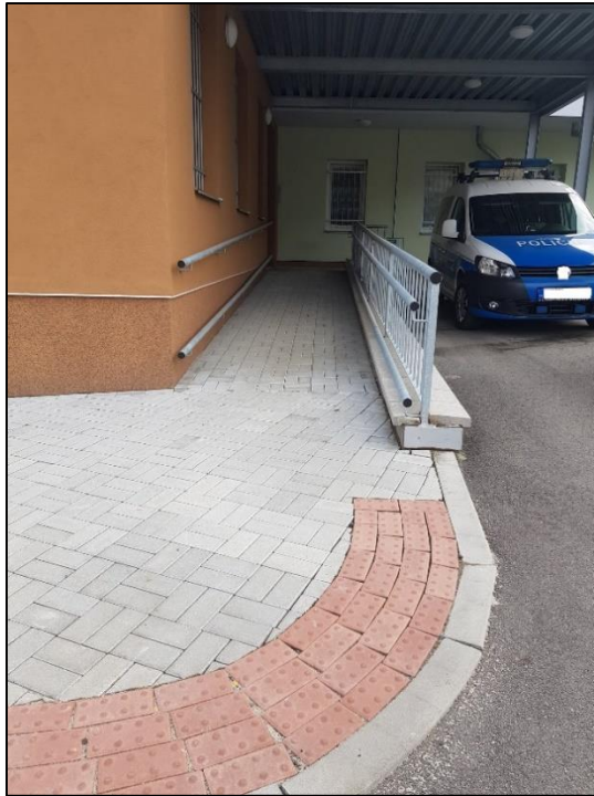
Obrázek 86 - Bezbariérová rampa u městské policie (správné řešení), zdroj: autorka DP
