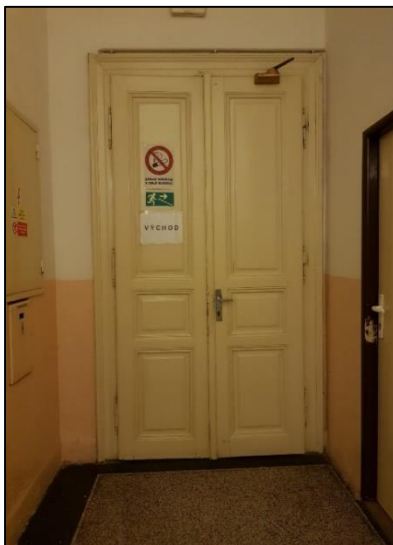
Obrázek 71 - Dvoukřídlé dveře v Budově MěÚ 1 (dveře umožňují průchod o šířce 700 mm, osoba na vozíku neprojde dveřmi), zdroj: autorka DP
