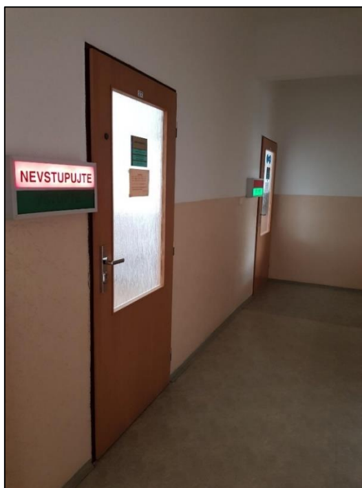
Obrázek 95 - Značení kanceláří v Budově MěÚ 2 (nesprávné umístění označení místnosti na prosklené části dveří), zdroj: autorka DP
