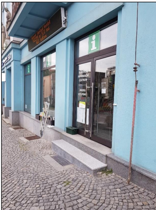
Obrázek 64 - Vstup do infocentra u Budovy MěÚ 1 (lze využít pouze vstup se schodišťovými stupni, přiléhající chodník nesplňuje požadavek na sklonitost), zdroj: autorka DP
