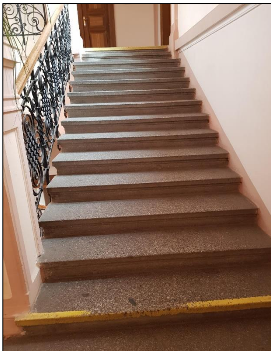
Obrázek 102 - Schodiště v Budově MěÚ 3 : pohled z mezipodesty (chybí druhé madlo), zdroj: autorka DP
