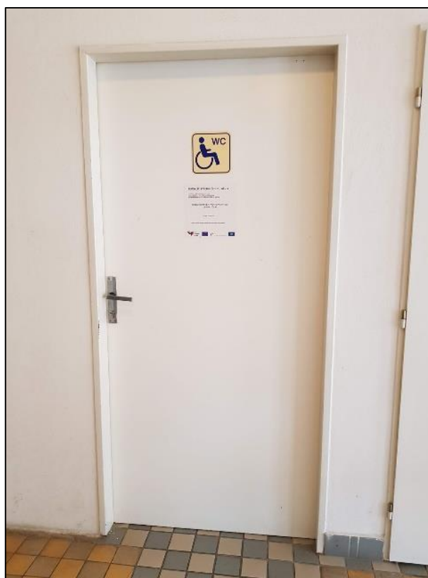
Obrázek 127 - Značení bezbariérové WC kabiny (značení je správné, bezbariérovou WC kabinu je možné navštívit pouze s tzv. euroklíčem, dveře se nesprávně otevírají dovnitř a chybí vodorovné madlo přes celou šířku dveří), zdroj: autorka DP
