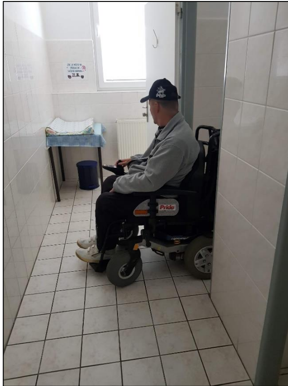
Obrázek 123 - Osoba na vozíku musí couvat do WC kabiny (nedostačující prostorové podmínky pro osobu na vozíku), zdroj: autorka DP
