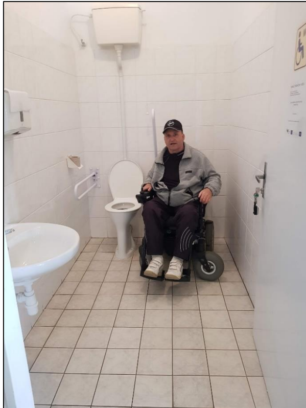
Obrázek 121 - Bezbariérová WC kabina v 1.NP (možnost plného otočení vozíku, prostorově vyhovující, nesprávné otevírání dveří do místnosti), zdroj: autorka DP
