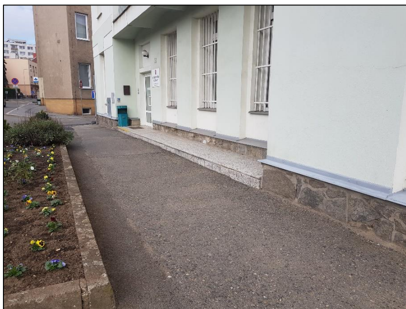
Obrázek 82 - Chodník před hlavním vstupem u Budovy MěÚ 2 (k hlavnímu vstupu je nutné zdolat 180 mm vysoký stupeň, osobě na vozíku není umožněný vstup bez pomoci druhé osoby), zdroj: autorka DP
