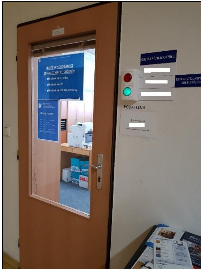
Obrázek 128 - Vstup do kanceláře pro příspěvky osobám se zdravotním postižením (chybí vodorovné madlo na dveřích, kontrastní značení je správně provedené), zdroj: autorka DP
