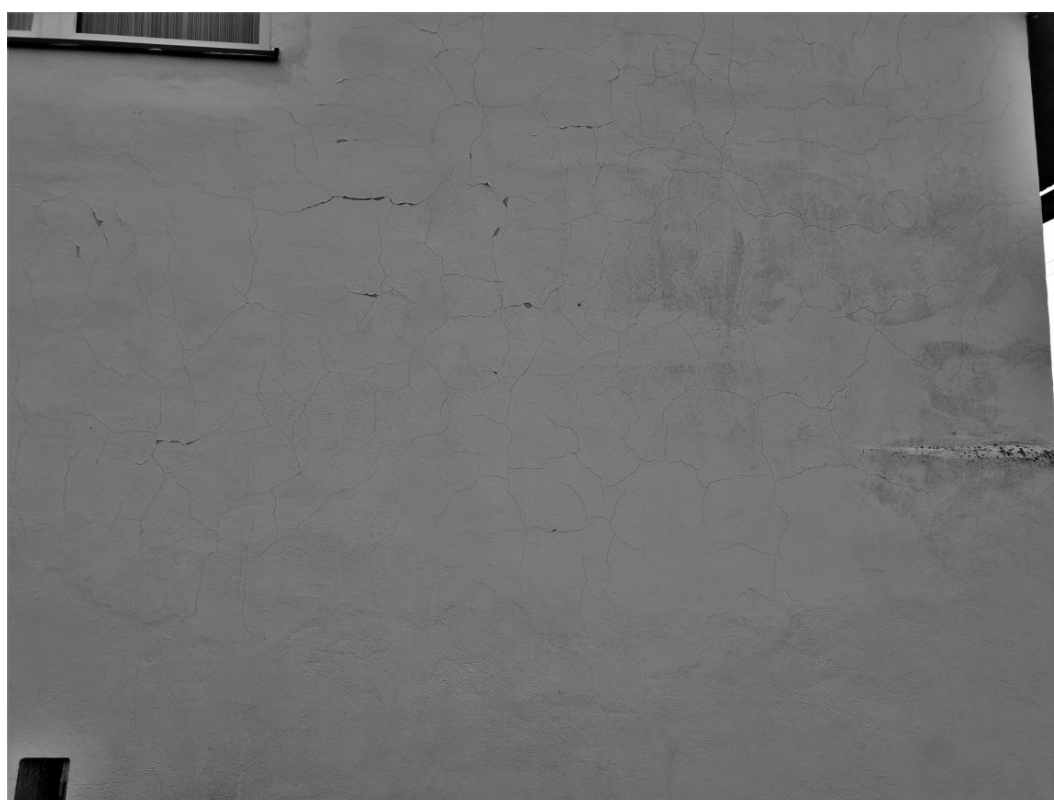
Obrázek 46 – Fotografie stavby poškozeného seismicitou []
