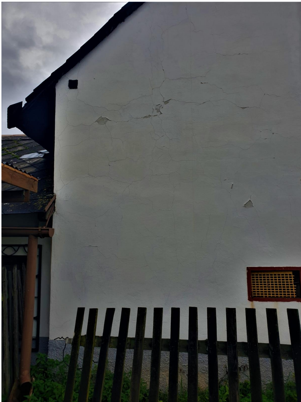
Obrázek 47 – Fotografie stavby poškozeného seismicitou [Autor]
