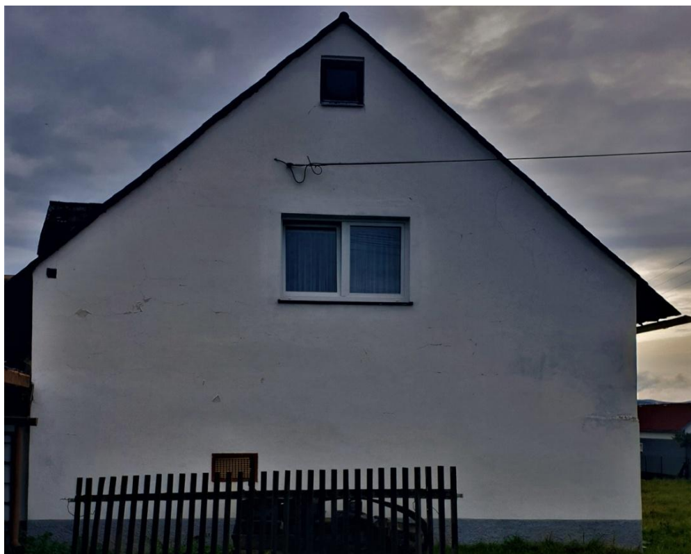
Obrázek 45 – Fotografie stavby poškozeného seismicitou []
