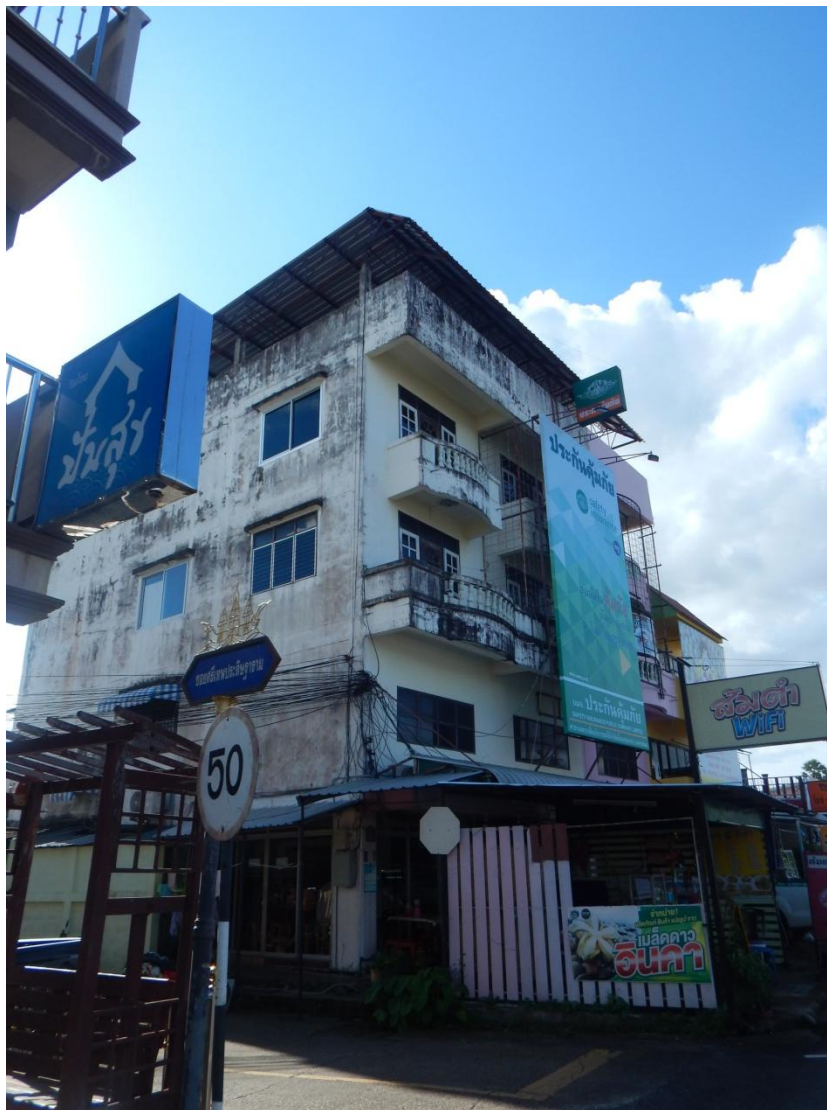
Obrázek 8 - Fasáda budovy poškozená vlhkostí (Zdroj: autor)
