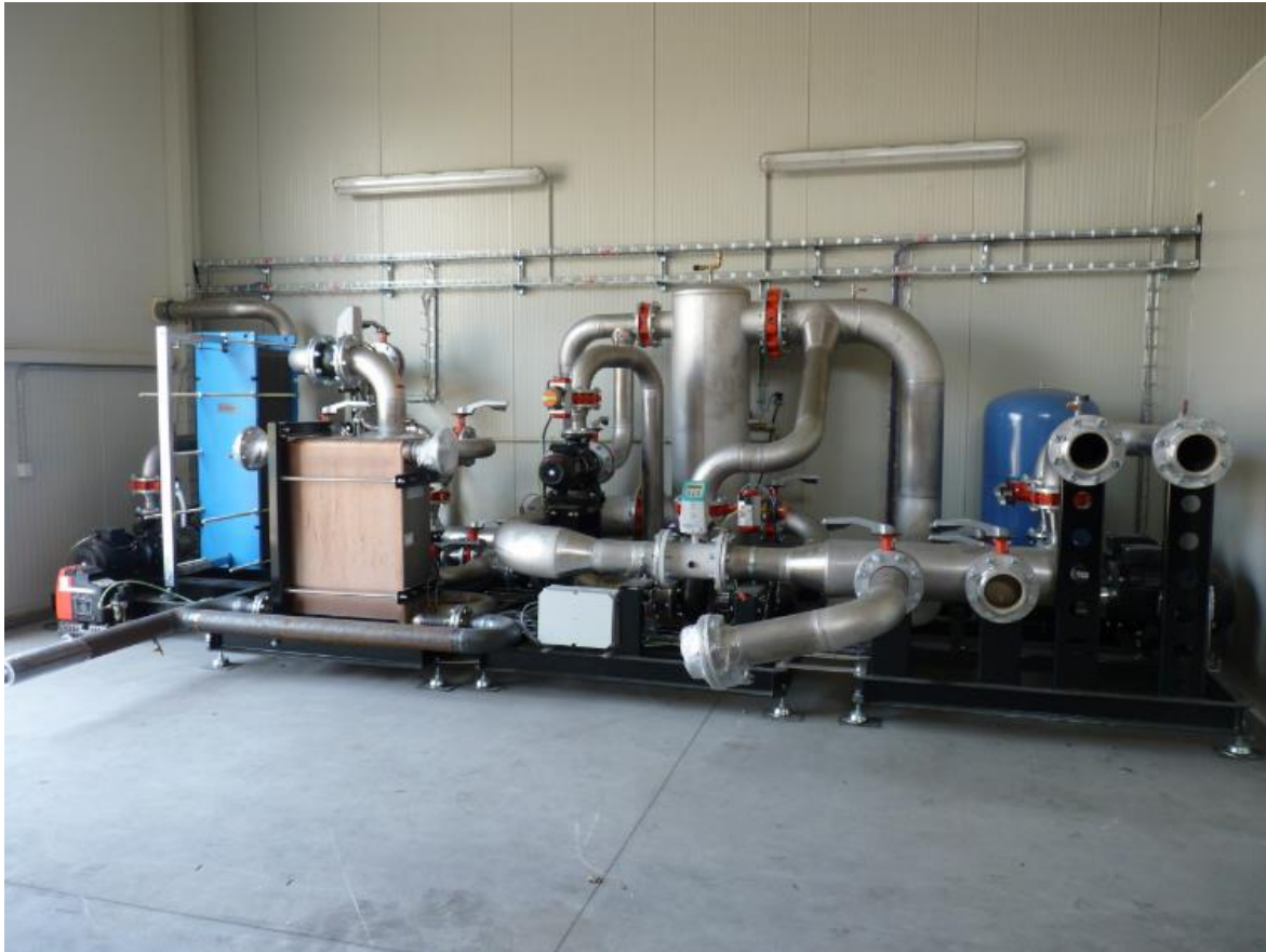
Obrázek 19: Nově vybudované zařízení v nové zkušebně pro zkoušení chladících zařízení, Zdroj: Vlastní
