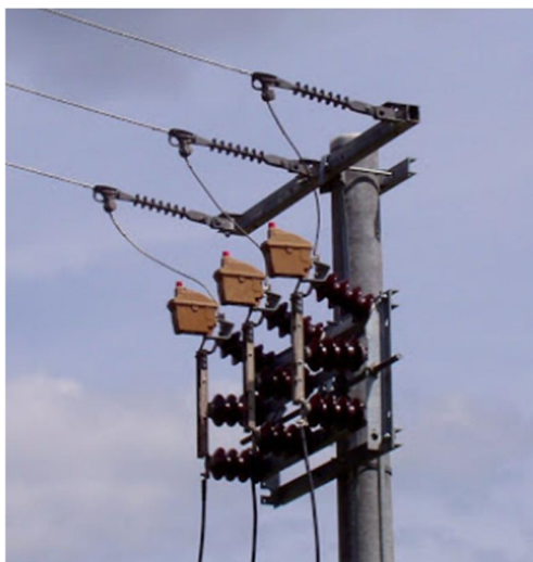
Obr. č. 2.13 – Svislý odpínač se zhášecími komorami FLA 15/6400
