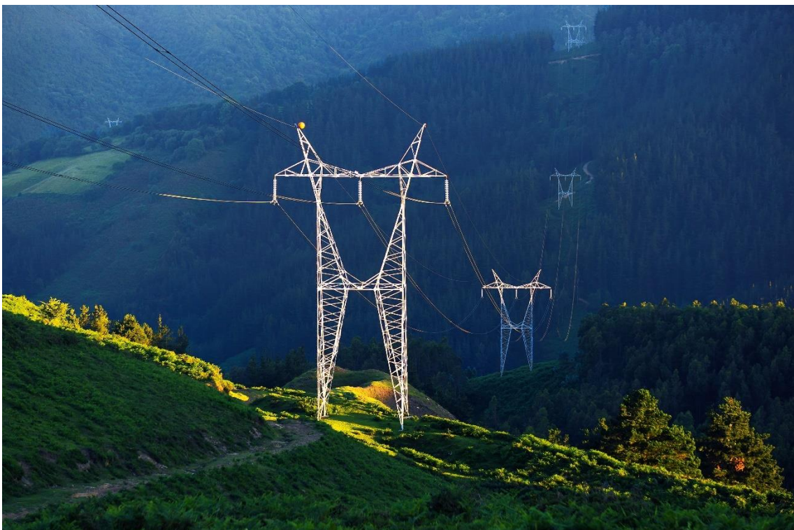
Obrázek 8 Stožáry vysokého napětí Zdroj: AdobeStock
