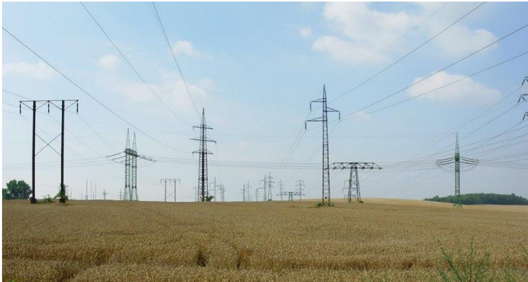
Obrázek 9 Stožáry vysokého napětí (Velká koncentrace stožárů v rovinném terénu) Zdroj: Dostupné z https://www.eon-distribuce.cz/clanek/prenosova-distribucni-soustava-1-cast
