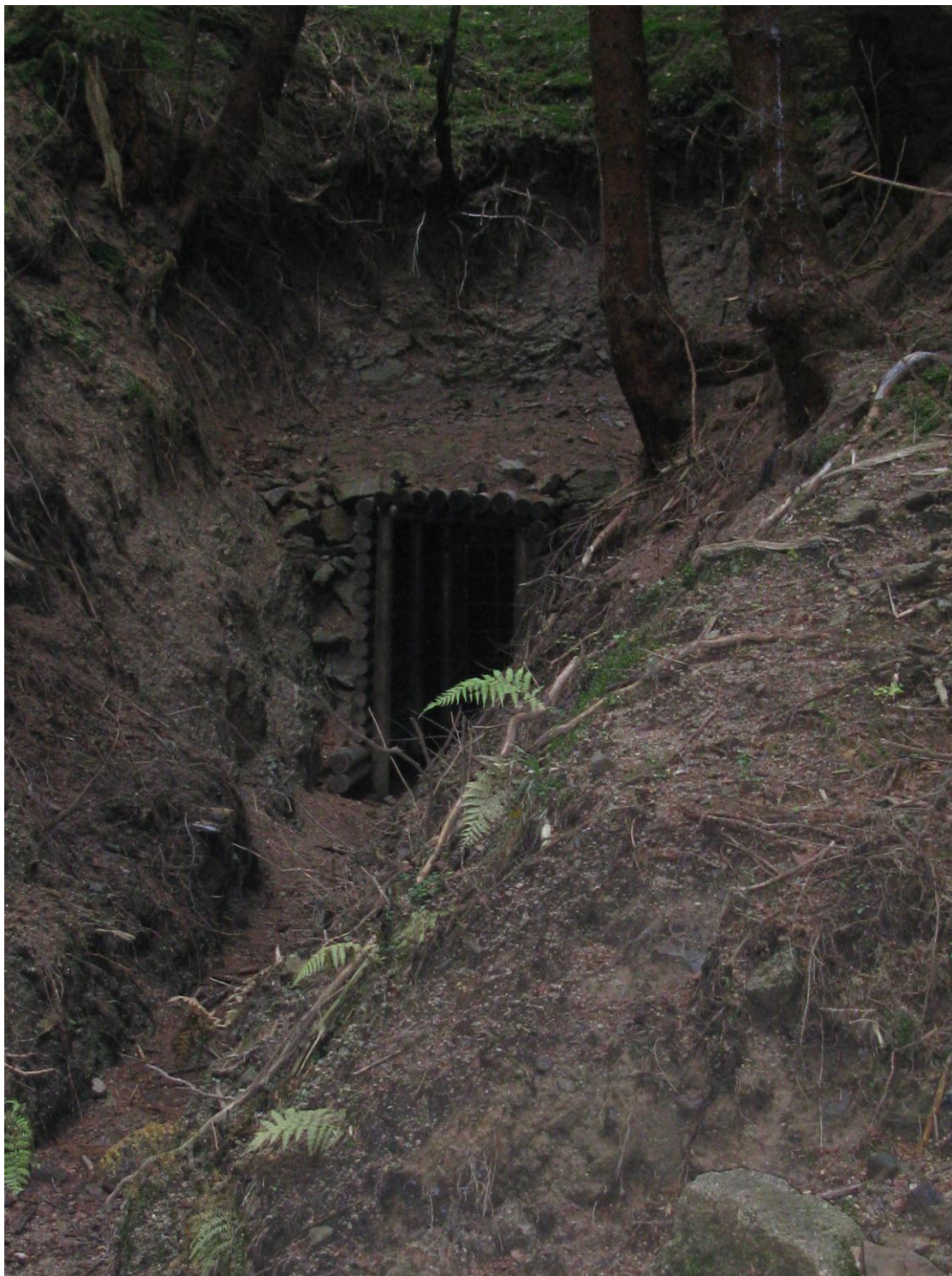
Obr. č. 17: Vstupní portál št. faráře Plössela po „zabezpečení“ r. 2011 – tímto zásahem bylo ústí a okolní relikty značně poničeny (foto autor)
