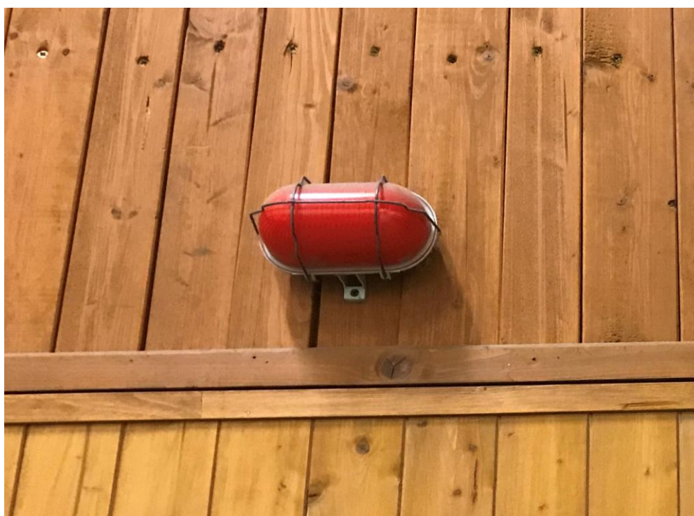
Obrázek 12: Červené výstražné světlo [Autor]
