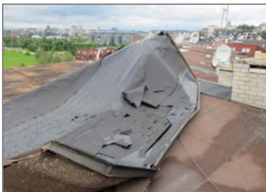
Obrázek 18: Porucha mechanického kotvení [21]
