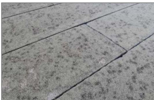
Obrázek 19: Poškození hydroizolačního povlaku kroupami [21]
