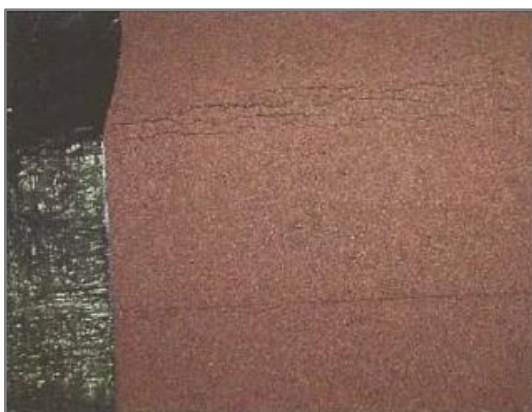
Obrázek 13: Praskání asfaltových pásů [21]
