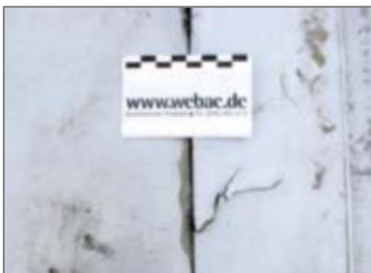
Obrázek 31: Poškození při odklizení sněhu [21]
