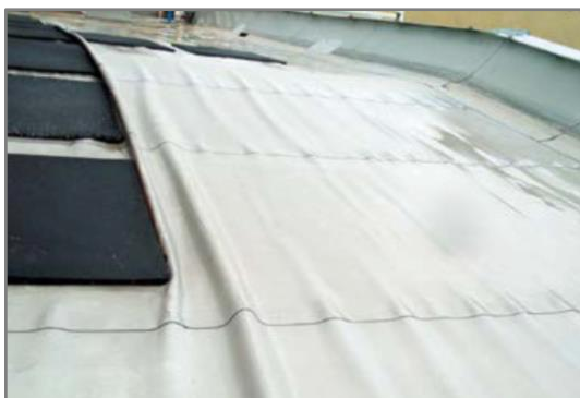
Obrázek 32: Vlnění povlaku z důvodu absence kotvení [21]
