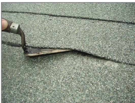
Obrázek 23: Nedostatečně svařený asfaltový pás [23]
