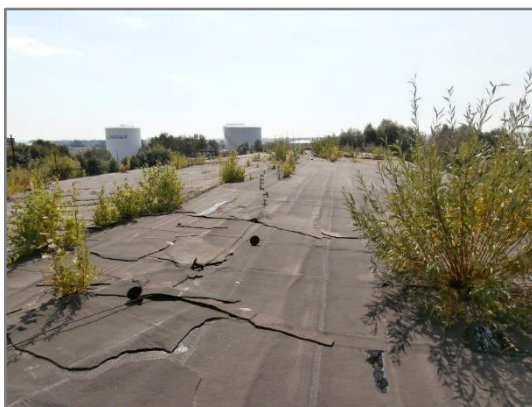
Obrázek 24: Zanedbání kontroly střešního pláště [23]
