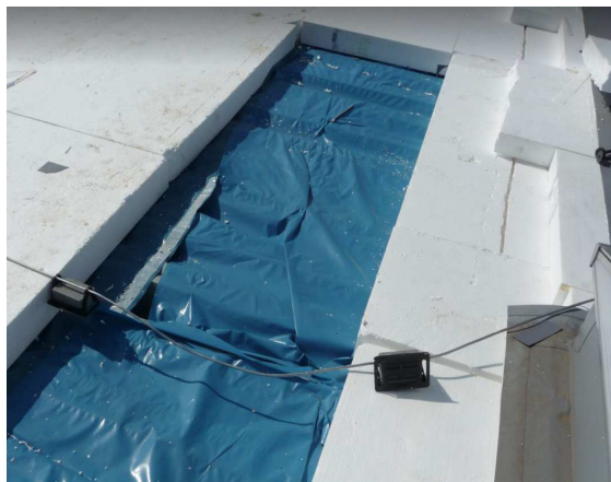
obr. /8/ Skladba PE fólií – nevhodně provedenou, zdroj: autor
