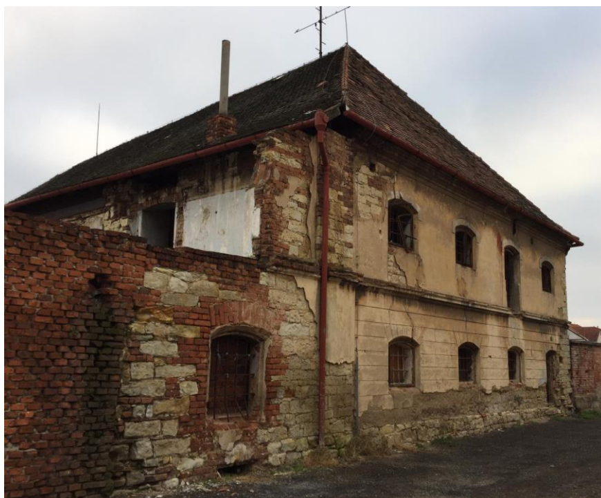
Prázdná budova, Žižkovo náměstí 83 – k demolici Zdroj - Vlastní fotografie, 2020
