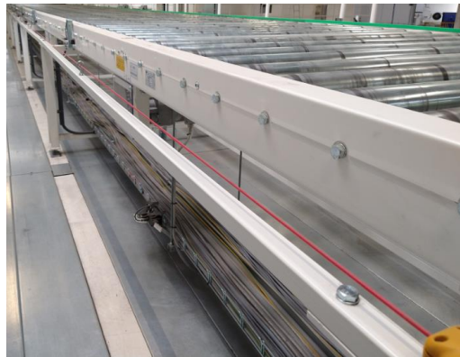
Obr. 27 Lanko nouzového zastavení
