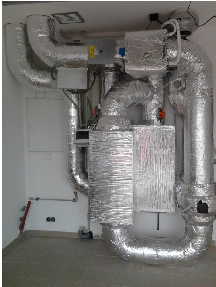
Obr. 4.3 Vzduchotechnika (Zdroj vlastní)
