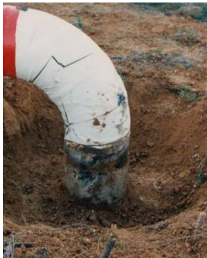
Obr. 14: Koroze v půdě [18]
