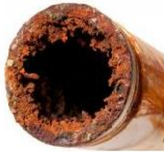
Obr. 13: Koroze uvnitř trubky [17]
