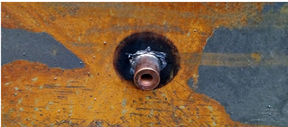
Obrázek 47: Čep přivařený na zkorodovaný povrch
