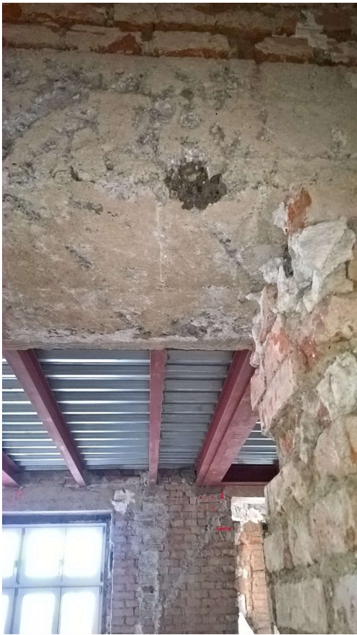
Obr.5.2.9.d – Sonda č.2 – porušení překlady
