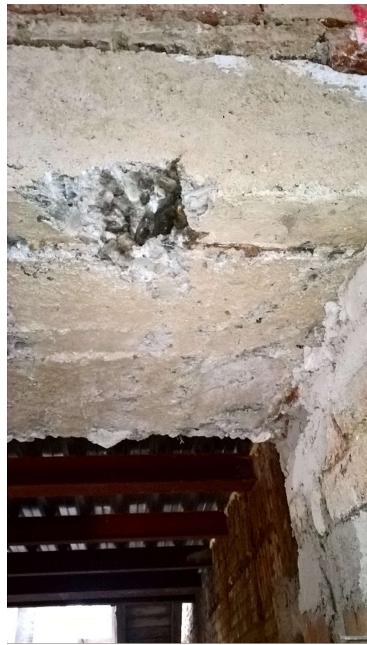
Obr.5.2.9.e – Sonda č.1 – porušení překlady
