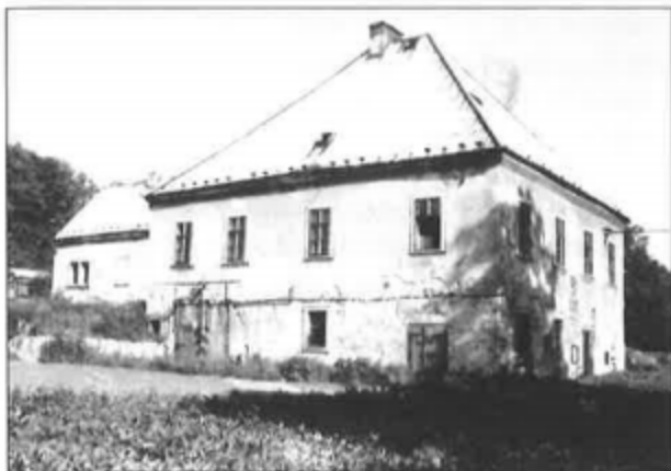
Krásný Les, severozápadní a jihozápadní průčelí zámku. Budova je již zčásti volně přístupná, nastává rozklad krytiny a destrukce omítek a oken. Stav 7. července 1995, foto autor.
