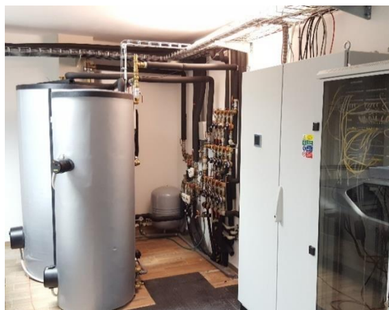
Obr. 2.51 Technická místnost budovy
