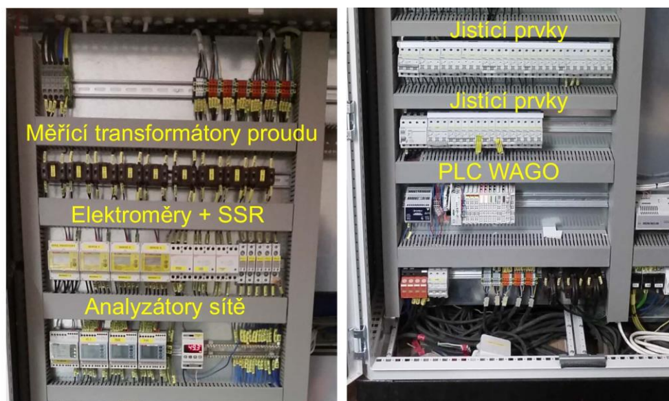
Obr. 2.52 Rozmístění měřících prvků v rozvaděči
