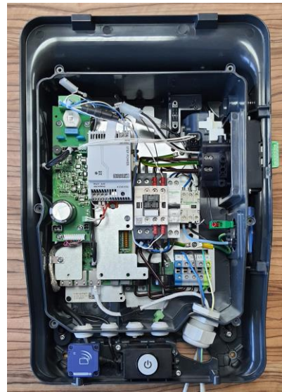
Obr. 3.25 Nabíjecí stanice Schneider electric EVB1A22P4ER
