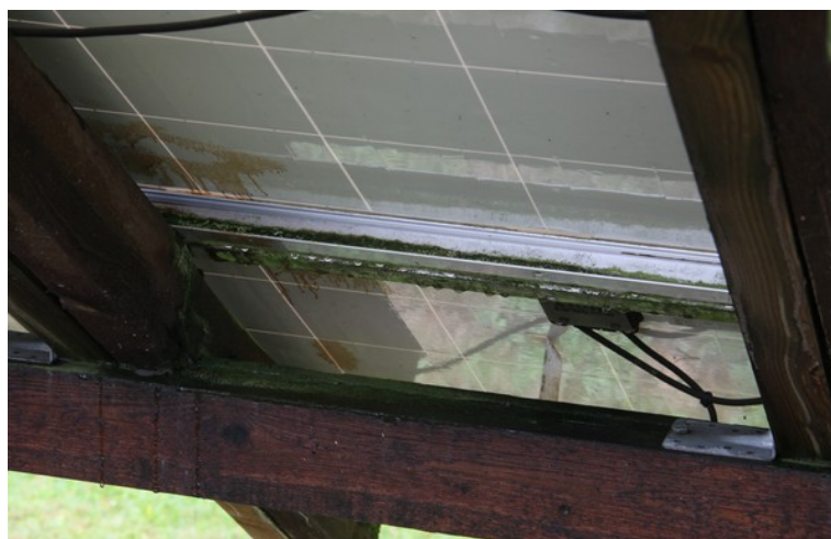
Obr. 8.7: Špatně umístěný spoj panelů
