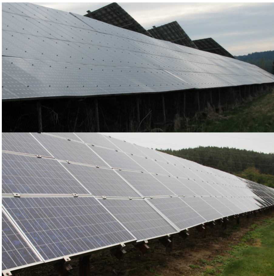
Obr. 8.6: Vadné zkroucené konstrukce
