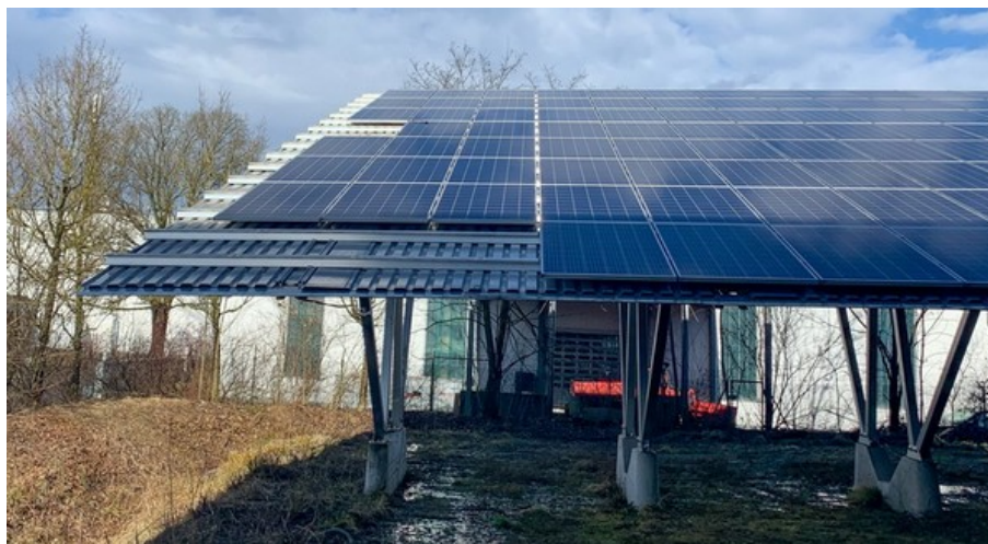
Obr. 8.9: Vadná konstrukce, která zapříčinila odtržení panelů
