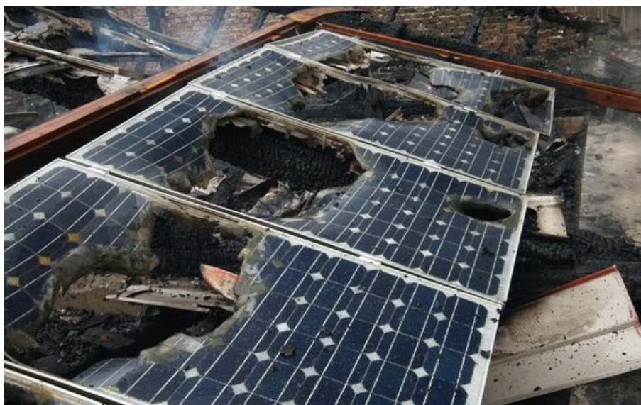
Obr. 6.2: Požárem poškozené fotovoltaické panely
