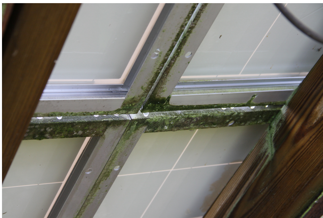
Obr. 8.2: Usazování živých organismů v důsledku vlhkosti na rámech panelů
