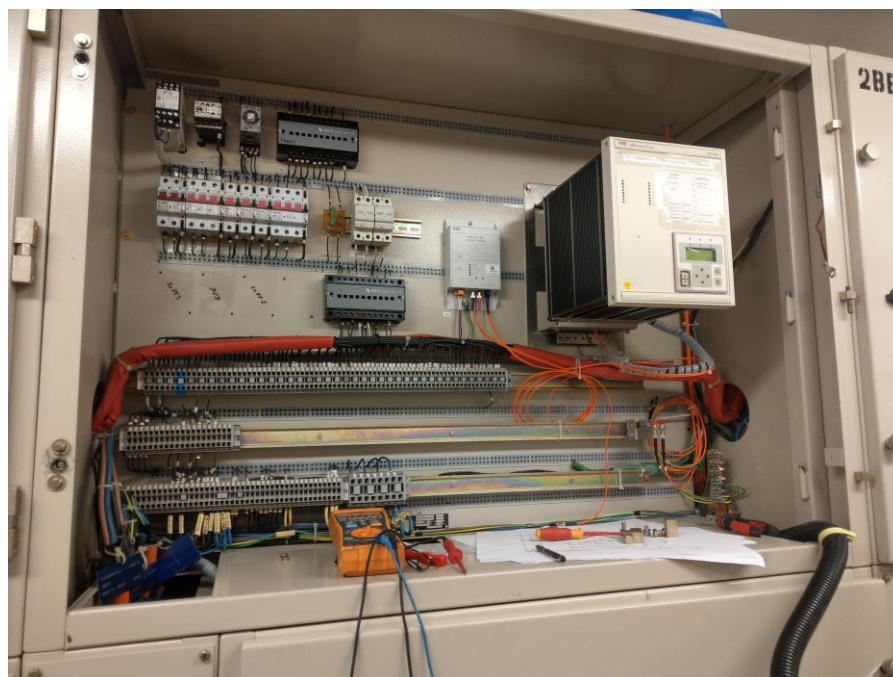
Obr. 3.11: Přístrojová část 2BB.8 včetně původní ochrany RET316*4 [zdroj: archiv autora]
