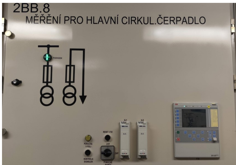
Obr. 3.15: Přístrojová část 2BB.8 v provozu [zdroj: archiv autora]
