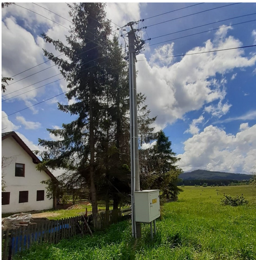
Obr. 13: Umístění regulačního transformátoru na podpěrném bodě u č.p. 257 [Zdroj: archiv autora]
