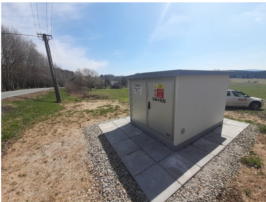
Obr. 24: Nově osazená TS Stögrova Hut' Pomník [Zdroj: archiv autora]
