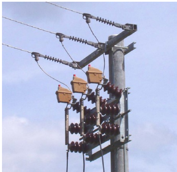
Obr. 2: ÚO s nainstalovanými zhášecími olejovými komorami [Zdroj: archiv autora]
