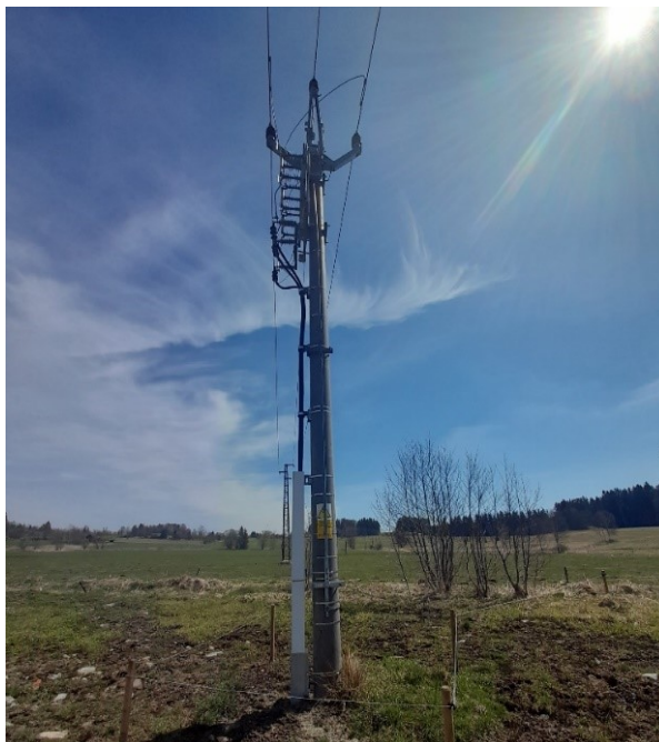
Obr. 22: Ukázka kabelového svodu + osazená výstražná tabulka [Zdroj: archiv autora]
