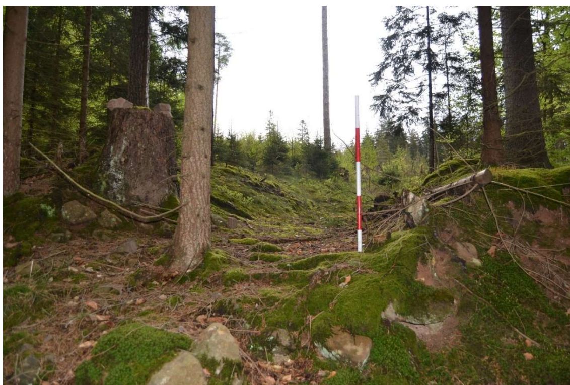
Obrázek 39: Destruovaný úvoz lesní technikou na lokalitě U Zlámané lávky. Autor: Tomáš Kroupa
