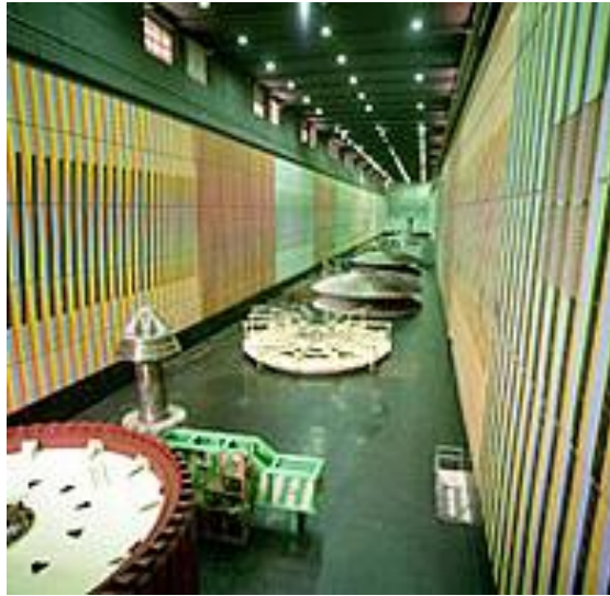
Obr. 30 Strojovna hydroelektrárny Guri [63]
