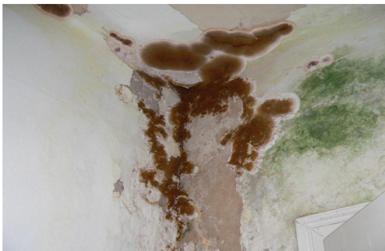
Foto 9: Ukázka rozsahu poškození budovy dřevomorkou. Zdroj: vlastní archiv Ing. Antonín Dvořák, kastelán zámku ve Vimperku
