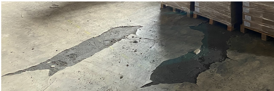
Obrázek 18: Příklad poškozené podlahy ve skladu
