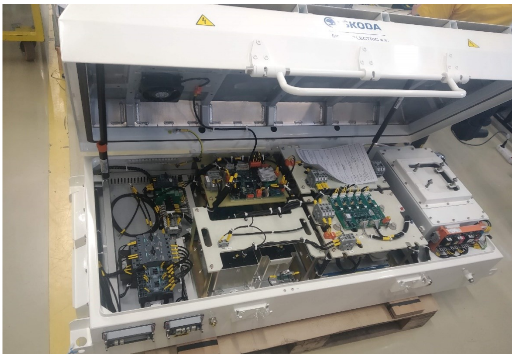
Obrázek 9 - Kontejner (střešní jednotka pro trolejbusy)
