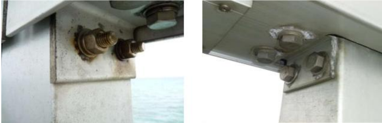
Obr. 5: Příklad kontaktní koroze [37]
