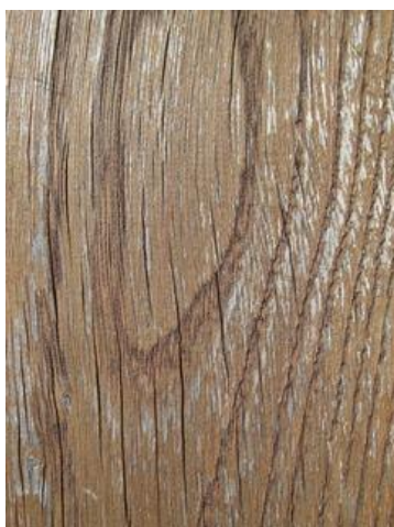
Obr. 20 - Degradace stejného pigmentovaného nátěru na bázi přírodních olejů na dubu po 18 měsíční expozici v exteriéru. (stavba.tzb-info.cz)
