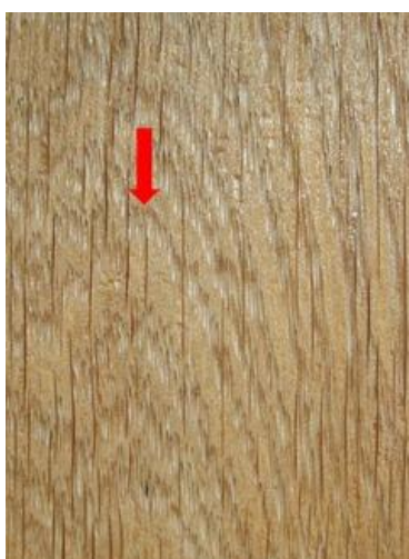
Obr. 19 - Začínající poškození transparentního akrylátového nátěru na dubu vystaveného v exteriéru na místě výskytu otevřených cév - viz šipka (stavba.tzb-info.cz).
