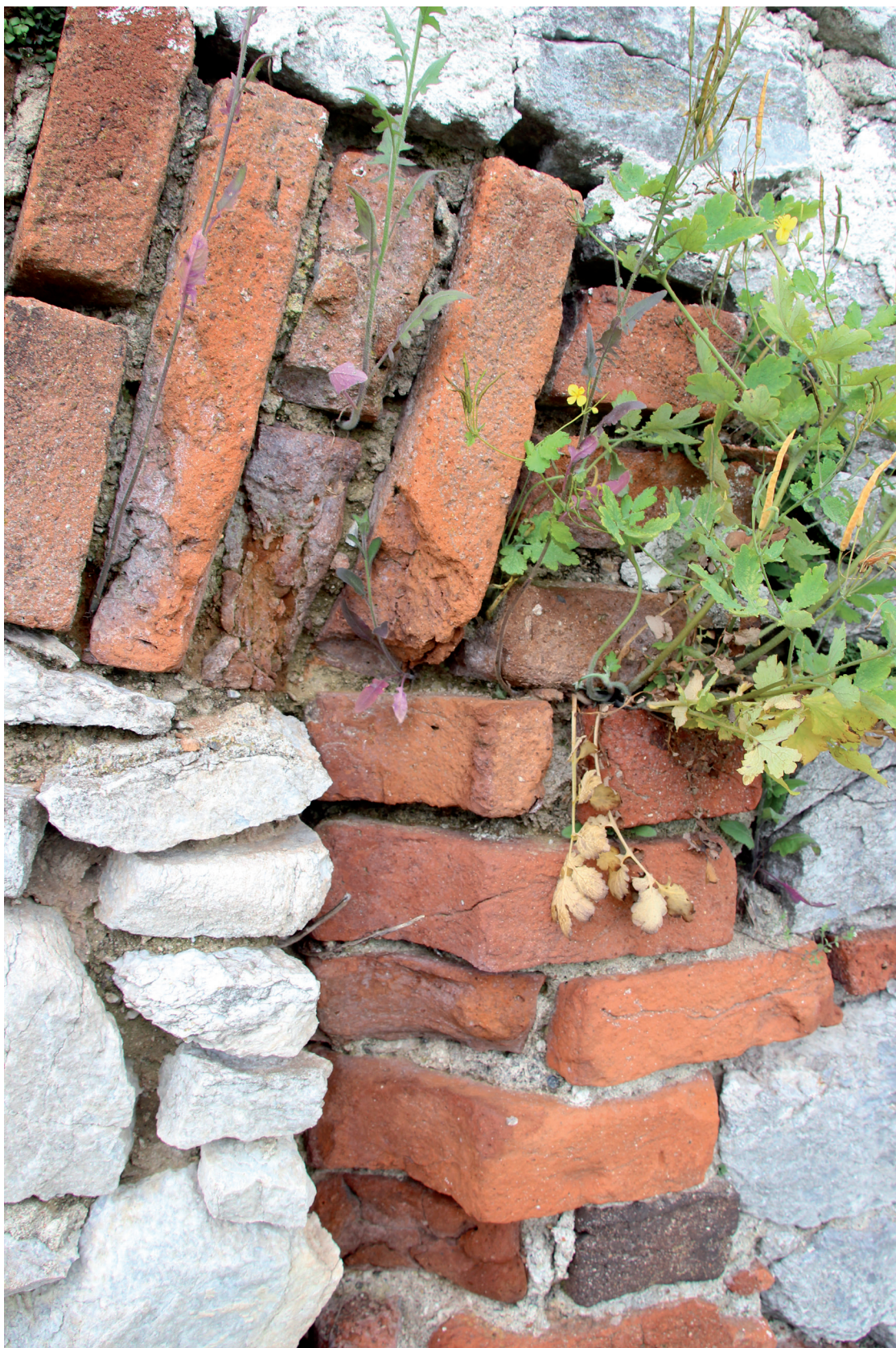
Obr. 11. Zazděné (nedokončené) pozdně gotické okno v 5. patře východního průčelí věžového paláce, s ostěním tvořeným cihelnými tvarovkami. Foto M. Patrný. – Abb. 11. Das zugemauerte (unfertige) spätgotische Fenster im 5. Stock der östlichen Stirnseite des Turmpalastes, mit der aus den Ziegelformsteine erzeugte Fensterleibung. Fotografie M. Patrný.
