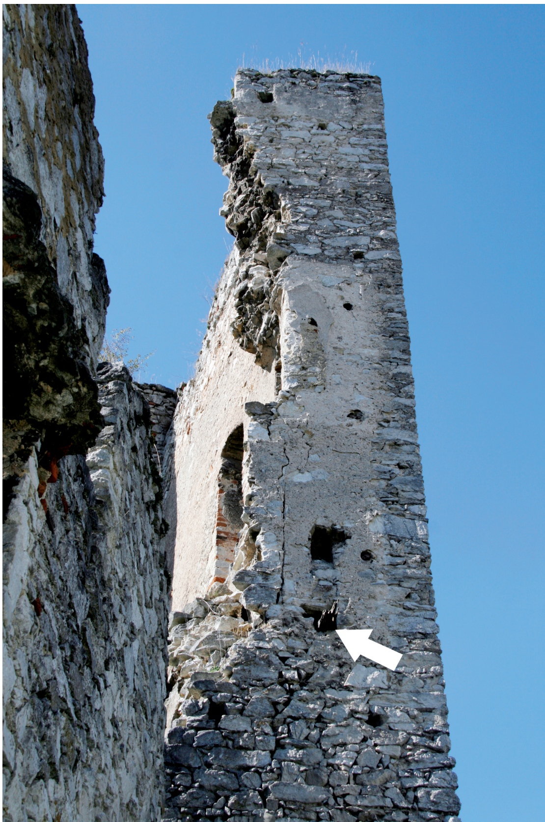
Obr. 13. Pohled na torzo zřícené východní boční zdi věže při 4. bráně. Šipka označuje umístění dubového trámku, datovaného do let 1392–93. Foto M. Patrný. – Abb. 13. Blick auf das Torso der niedergerissenen östlichen Seitenmauer bei dem 4. Tor. Ein Pfeil bezeichnet die Stelle des Eichenbalken, datierten in den Jahren 1392-1393. Fotografie M. Patrný.
