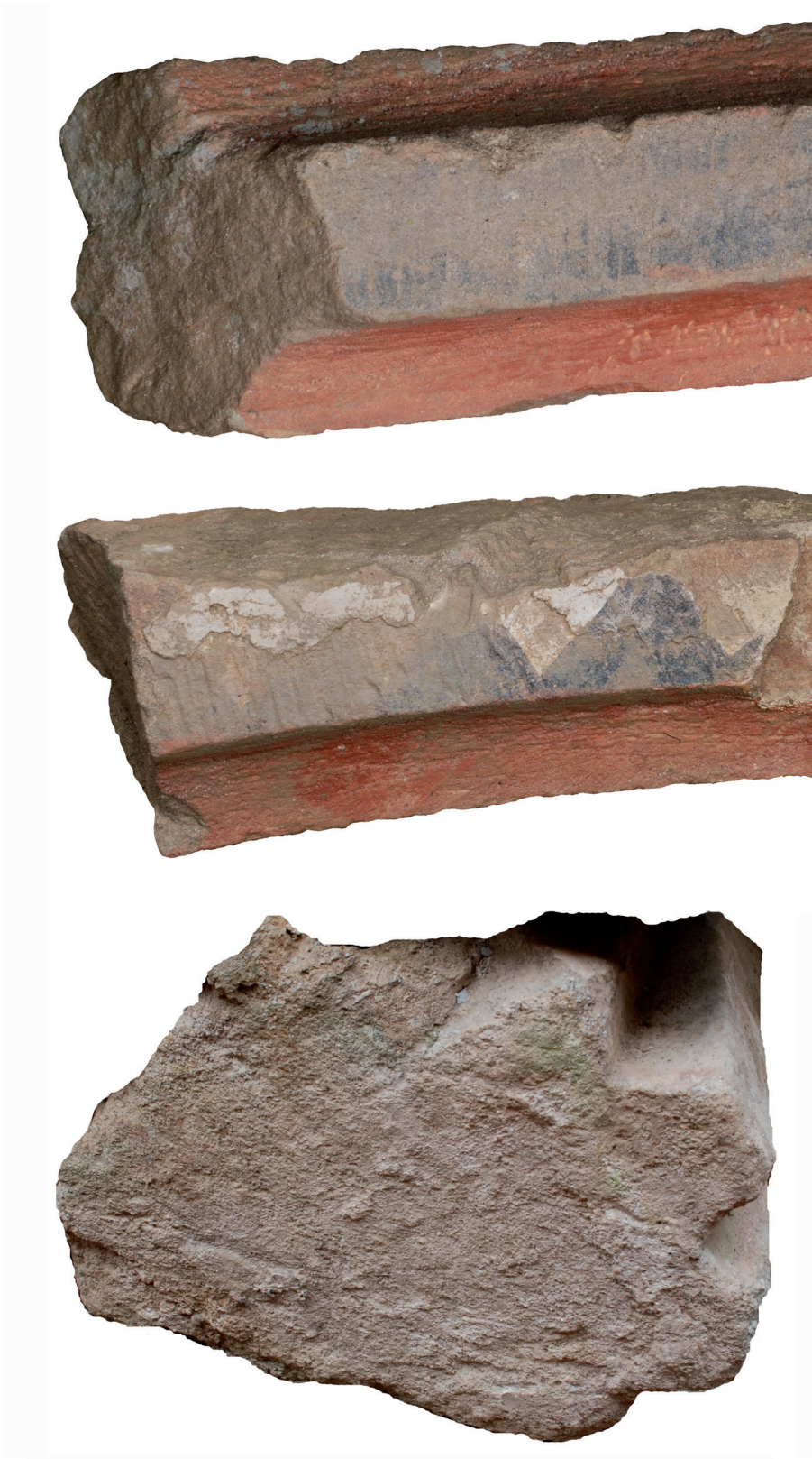
Obr. 23. Škvorec-Starý zámek, ukázka reliktní klenebních žeber odkrytých při archeologickém výzkumu J. Špačka 2008–2010. Foto L. Kursová. – Abb. 22. Škvorec-Starý zámek, Probe der Relikte der Gewölberippen, die bei den archäologischen Untersuchungen von J. Špaček 2008–2010 gefunden wurden. Foto L. Kursová.
