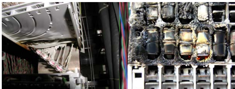
Obrázek 2 Havárie způsobené statickým přetížením bleskojistek
