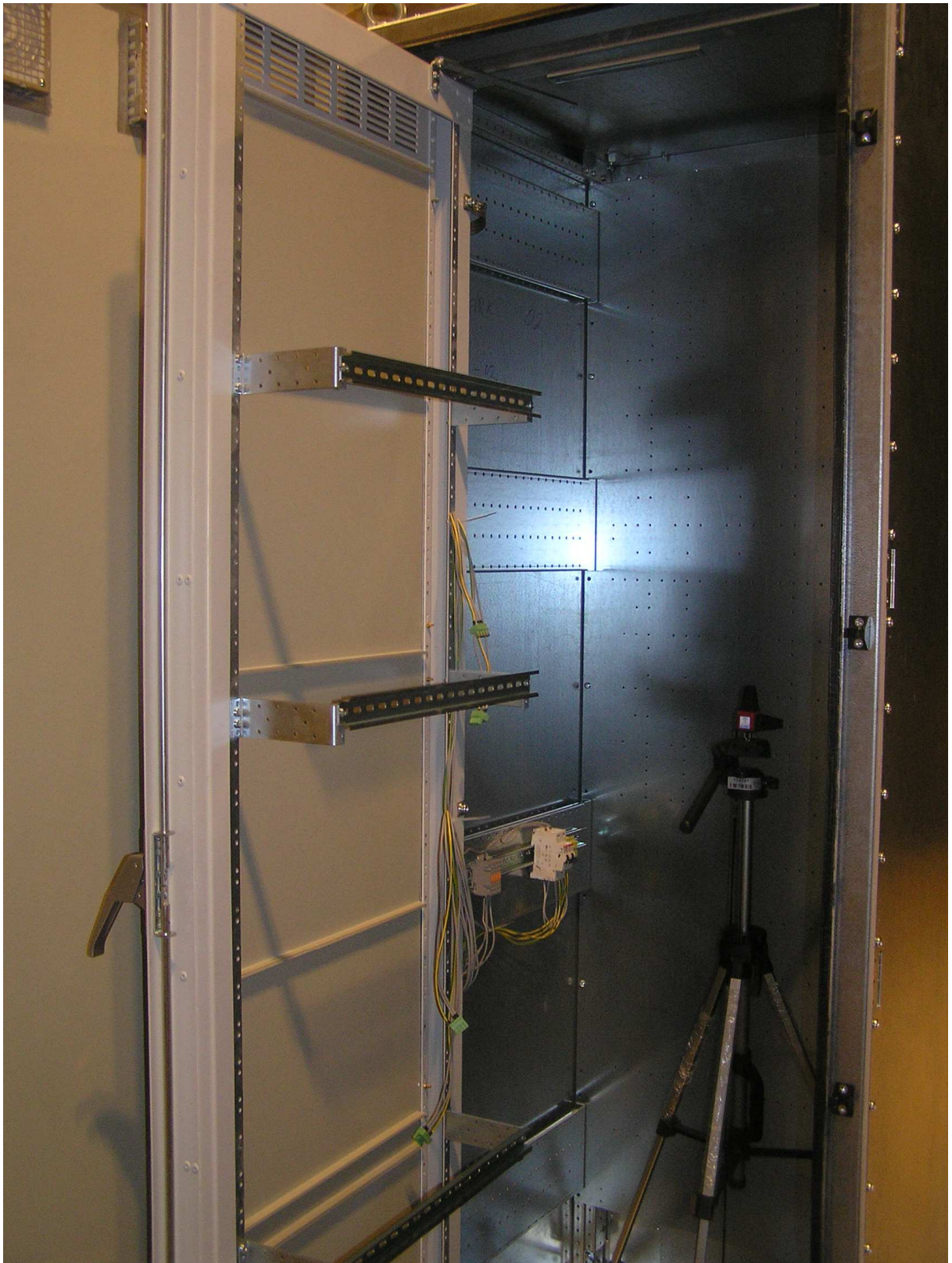
Obr. A.4: Vnitřní uspořádání rozváděče se sondou elektrického pole
