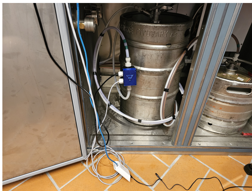
Obrázek A6: Detail na průtokoměr připojený k potravinářskému potrubí
