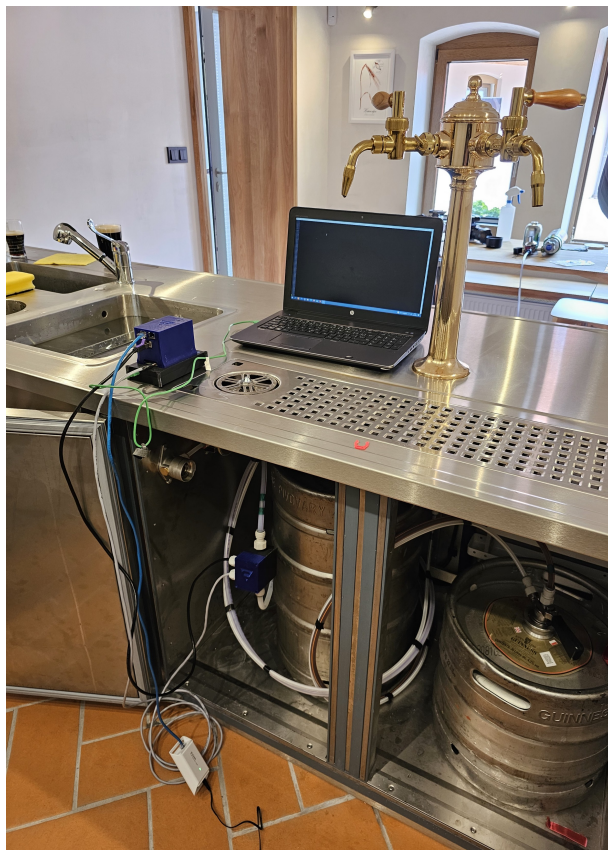
Obrázek A5: Indukční průtokoměr instalovaný ve výčepním zařízení
