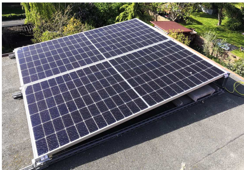
Obr. 11: Instalované fotovoltaické panely
