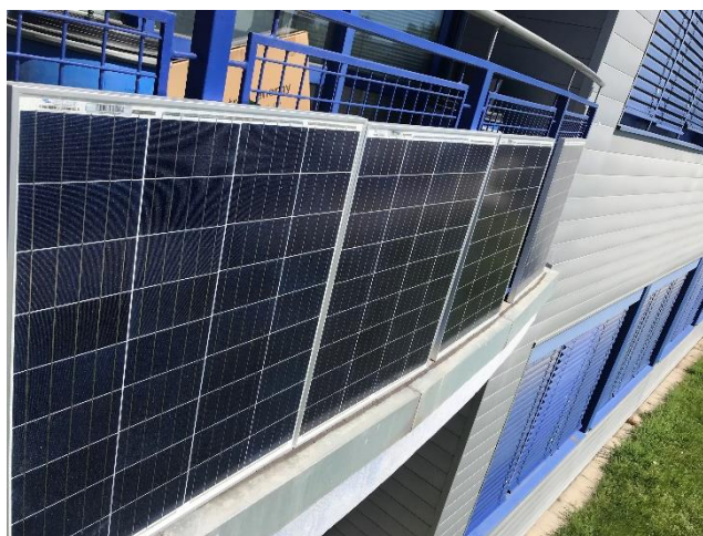
Obr. 4.3 Umístění fotovoltaických panelů
