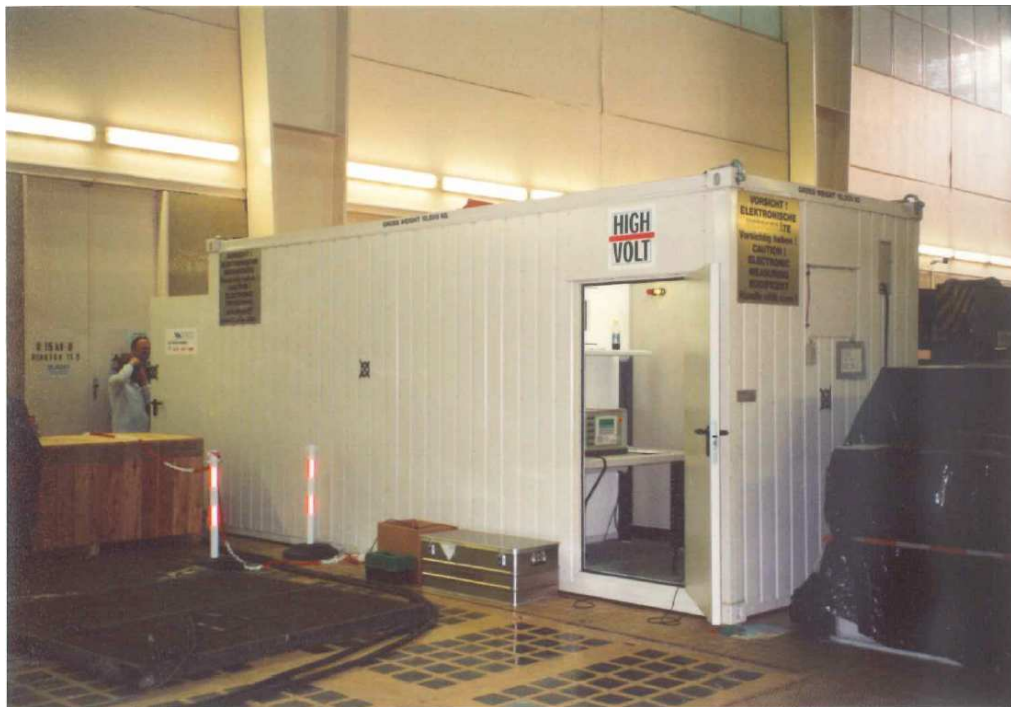
Obr. 33: VN zkušebna položená ve strojovně
