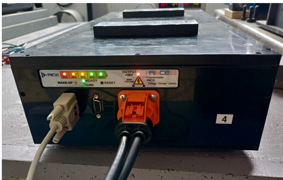
Obr. 60: Baterie na měřicím stanovišti
