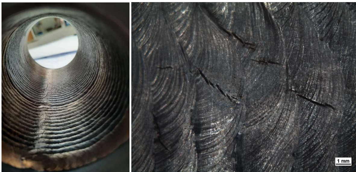
Obrázek 8-12 Horké trhliny na povrchu 1. vrstvy návaru na tělese H1
