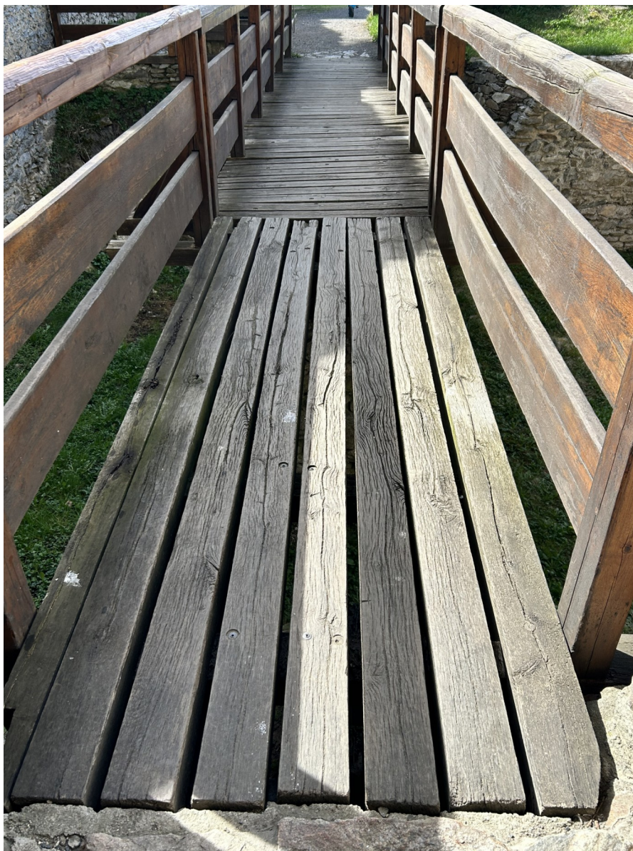
Příloha č. 10: Zrekonstruovaný můstek do purkrabství hradu Kašperk 80
