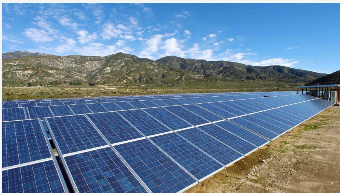
Soustava solárních panelů na CSUSB
