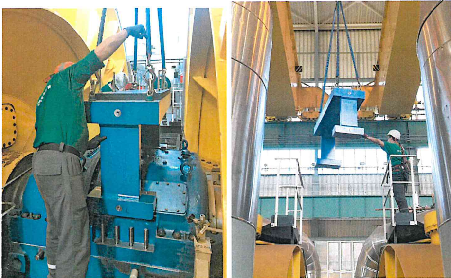
Obr. 1.5: Pasivní hltič instalovaný v jaderné elektrárně Temelín [11].
