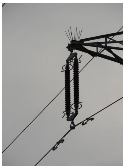
Obrázek 26 - ochranné tyče na sloupu 400kV
