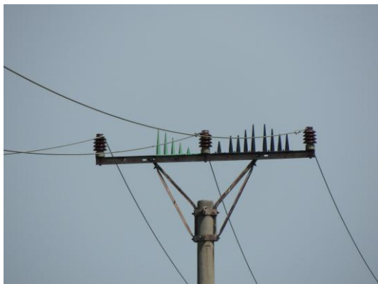
Obrázek 31 - hřebenové zábrany zničené vlivem povětrnostních podmínek
