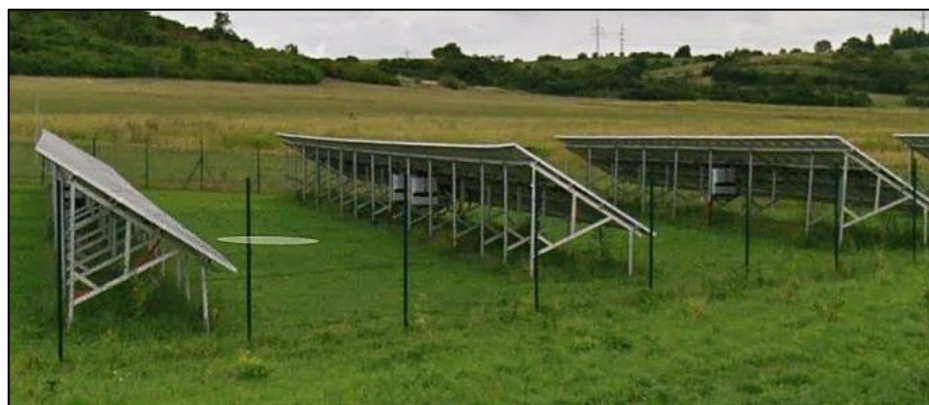
Obr. p.6 Řady FV panelů se střídači
