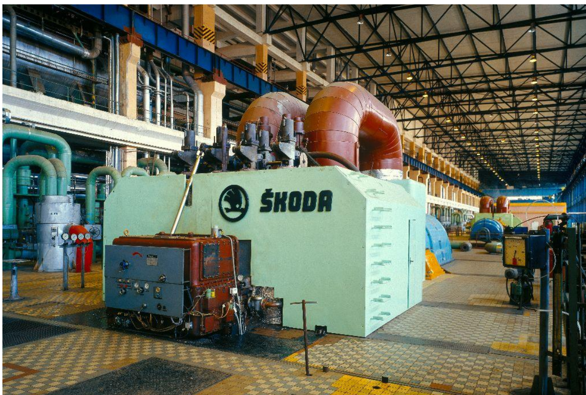
Obr. č. 3: ČEZ a.s., OJ elektrárna Tisová – turbogenerátor č. 2, zdroj [11].
