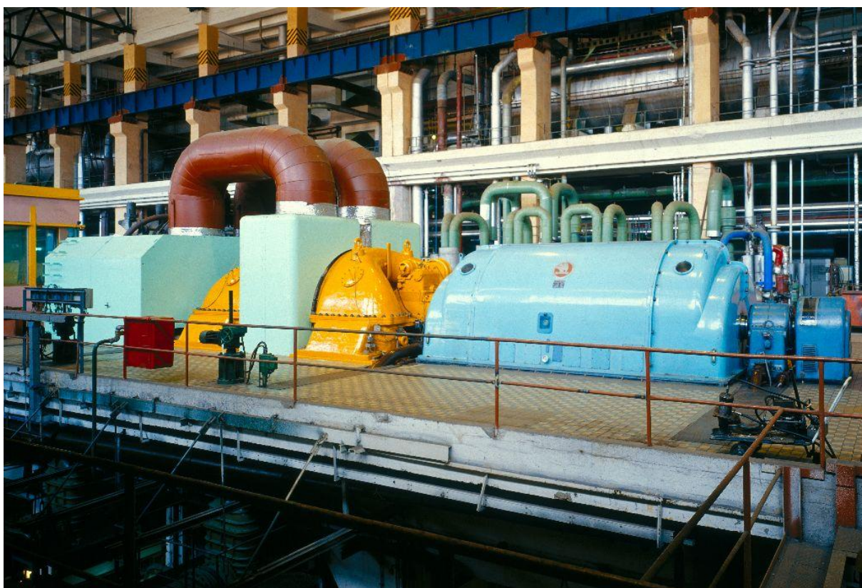
Obr. č. 3: ČEZ a.s., OJ elektrárna Tisová – turbogenerátor č. 4, zdroj [11].
